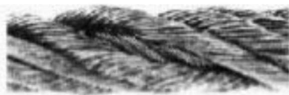
FIG. 14.4 — Alma do cabo a descoberto, com aumento local do diâmetro devido à abertura. Este estado exige a substituição.
