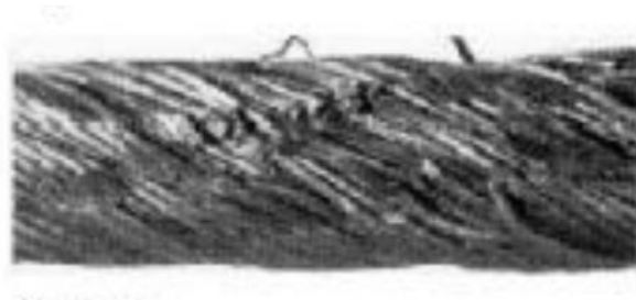
FIG. 14.2 — Usure importante et nombre notable de fils rompus. Frottement sous tension sur arête vive. Cet état exige le remplacement immédiat.
