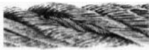
FIG. 14.4 — Âme du câble à découvert, avec augmentation locale du diamètre due à l'ouverture. Cet état exige le remplacement.
