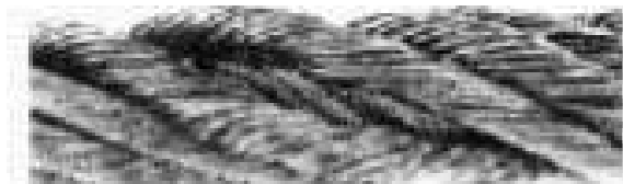
FIG. 10.4 — Núcleo del cable al descubierto, con incremento local del diámetro debido a la abertura. Dicho estado requiere la sustitución.
