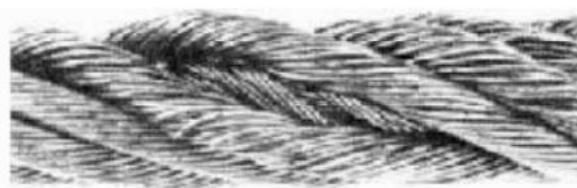
FIG. 7.4 — Núcleo del cable al descubierto, con incremento local del diámetro debido a la abertura. Dicho estado requiere la sustitución.
